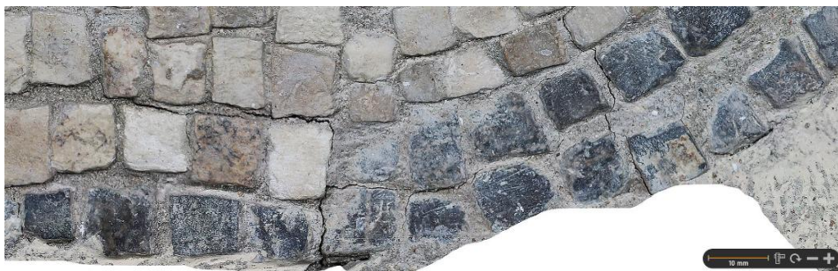
Fig.29. Zona perimetral donde se localizan fisuras
