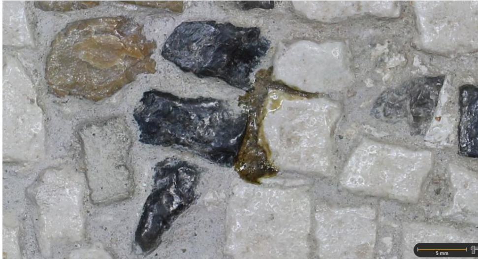
Fig. 13. Manchas de pintura y mancha sin identificar
